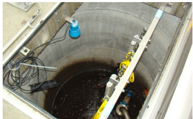
Bild 7: Installation einer Siemens SITRANS LU Ultraschall-Füllstandmessung im Pumpschacht einer Kläranlage
